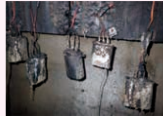
分電盤に並ぶ焼損したコンデンサ
